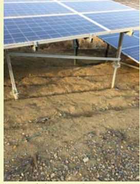
①水が流れた跡 雨水が太陽光パネルの下を流れて調整池に集水します。
