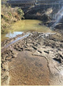
②調整池 雨水に混ざった土粒子が調整池に堆積されています。深さ4mあったはず池底が見えてきております。
