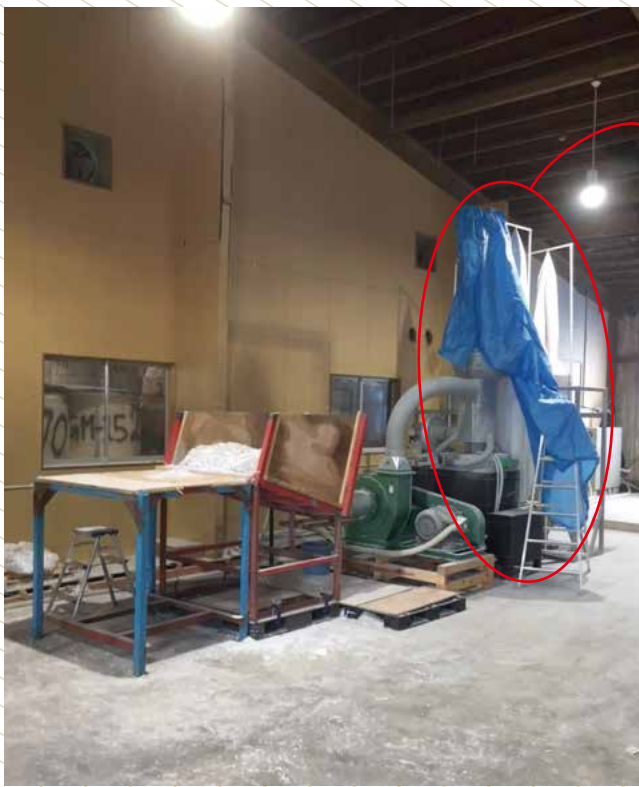
台風の影響で雨漏りし、応急措置です。
