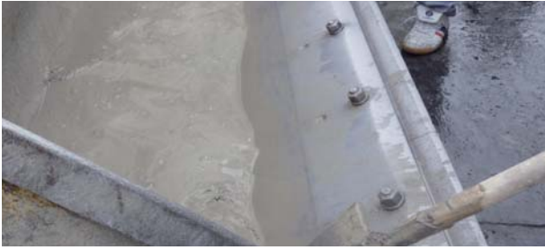
生コン工場で発生するスラッジ水
